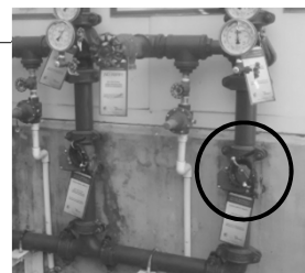
Supervisión de rociadores
