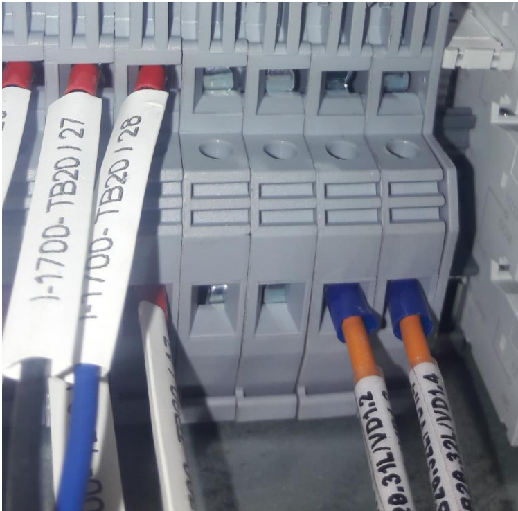
Maquillado de cables
