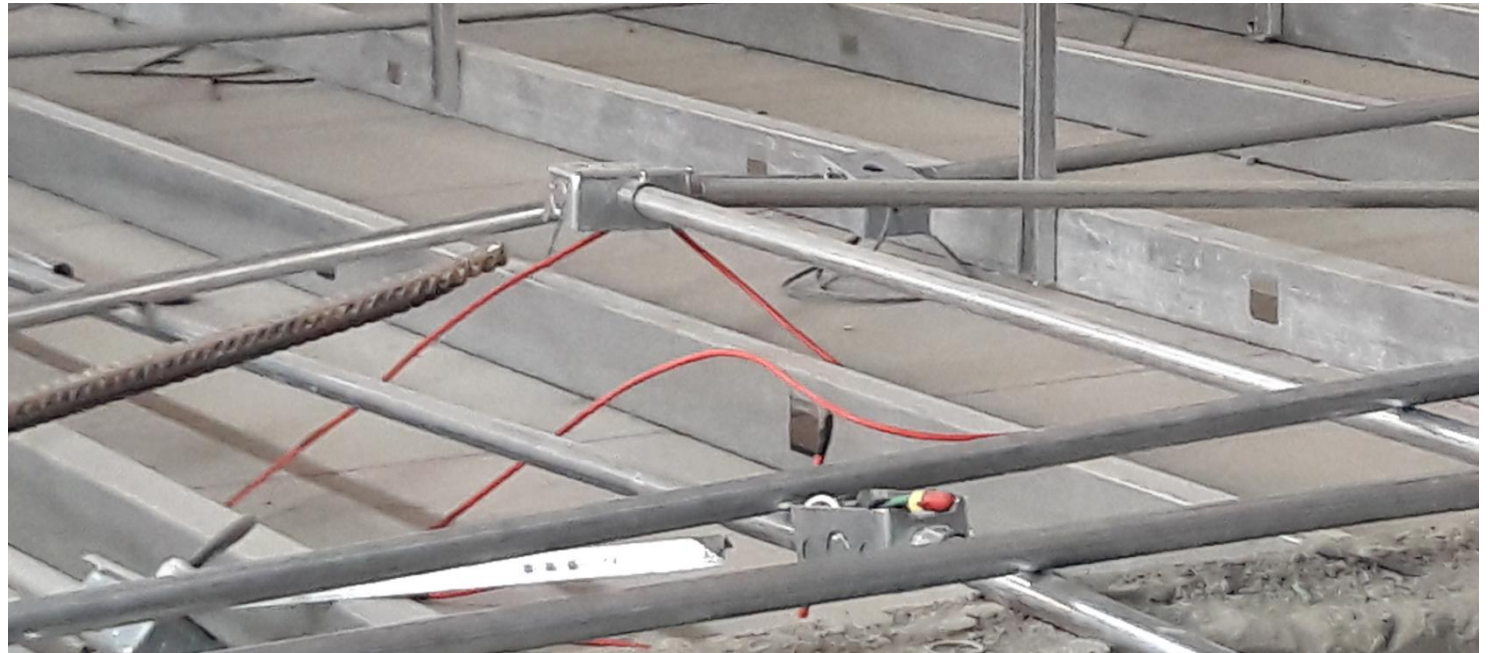
Evitar estas instalaciones
