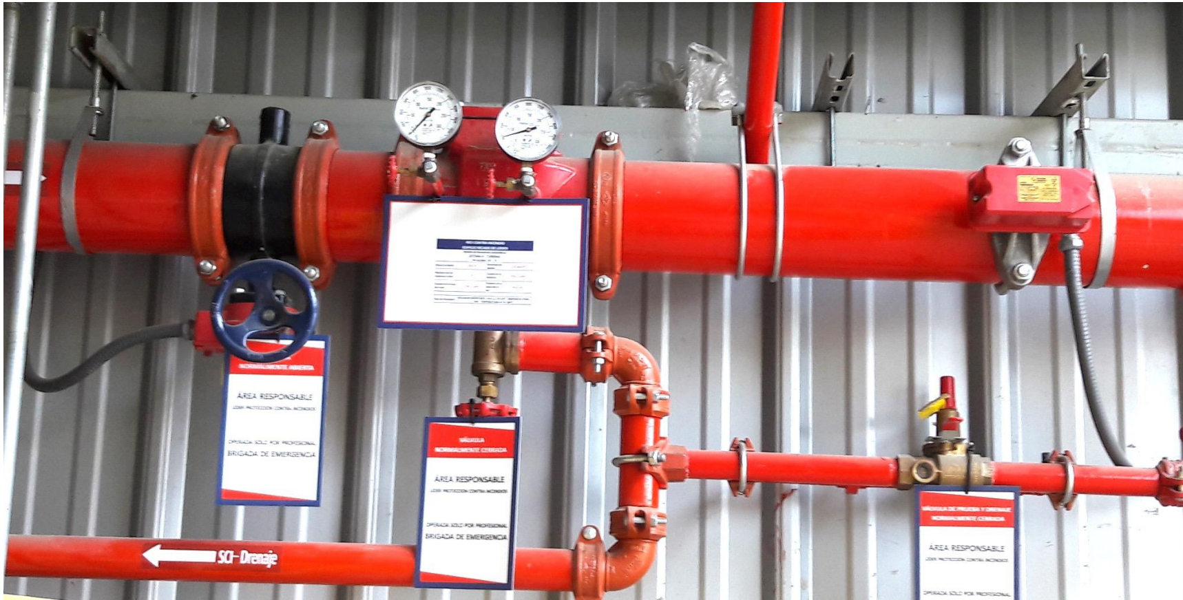
Supervisión típica de estación de control: Posición de válvula e interruptor de flujo
